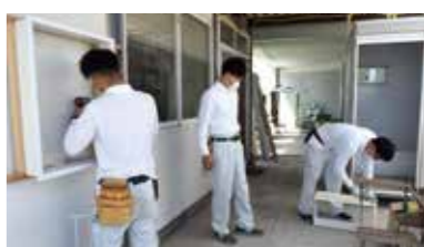
ユニットバスの設置練習をする様子。「施工不良が起きても、組み方の何が悪かったのかを理解していない業者や職人も多い。当社では基礎からしっかり教え、実物を使った練習を徹底しています」と小杉さん。
